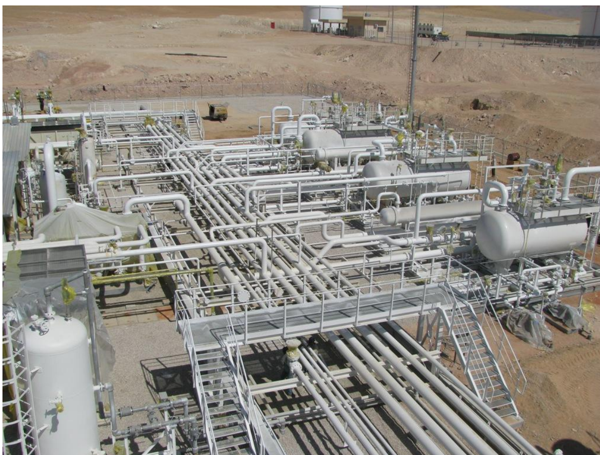
Slika 5.2 Postrojenje Jihar Faza 2 u Siriji
