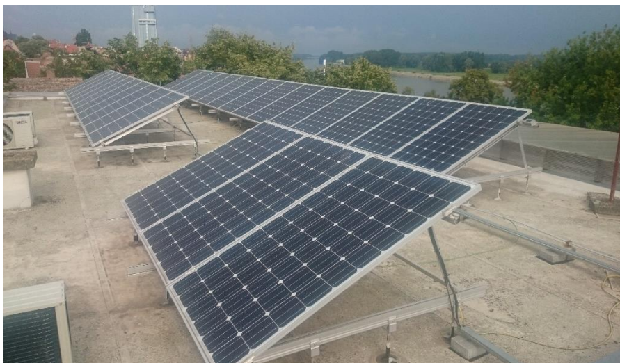
Slika 5. Dio postavljenih FN modula na krovu upravne zgrade Elektroslavonije Osijek
